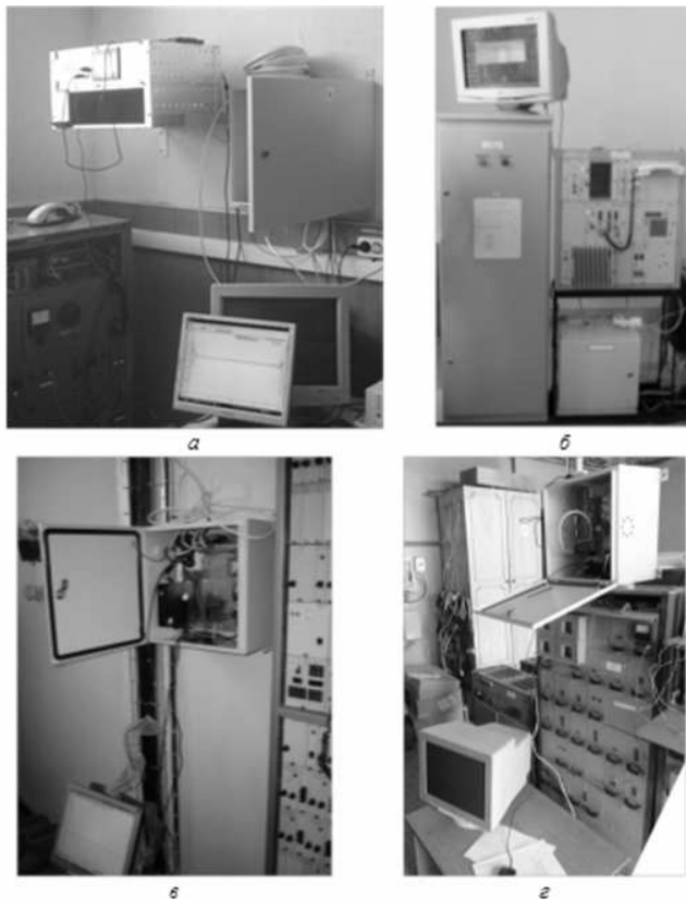
Рис. 1. Аппаратура локационного зондирования линий электропередачи, установленная на подстанциях: а – «Кутлу Букаш» (ОАО «Сетевая компания»); б – «Шкапово» (ОАО «Башки-рэнерго»); в – «Бугульма-500» (ОАО «Сетевая компания»); г – Баксан (ОАО «МЭС Юга»)
