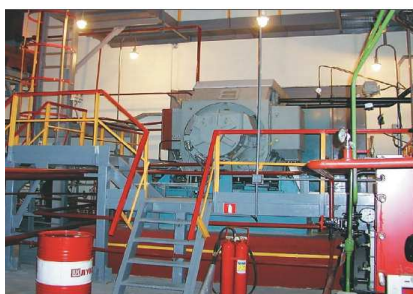
Рис. 2. Помещение генераторного отделения
